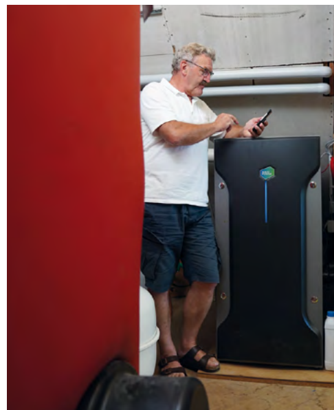
Eine Erdgas-Brennstoffzelle im Keller bedient effizient und klimaschonend den Energiebedarf in Privathaushalten. Hariof Schmid aus Heitersheim hat sich 2020 für diese Lösung entschieden.
